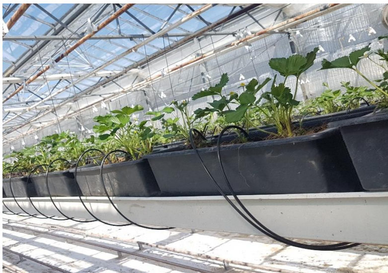
Hængende system med trug, hvor vandingen sker med spaghettidryp, som fødes fra en slange under renden.
